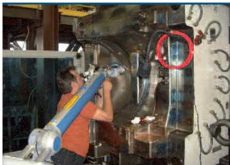
Soudage de réparation mobile dans la machine sur pièce moulée par injection (photo : Jutz Lasertechnik)
